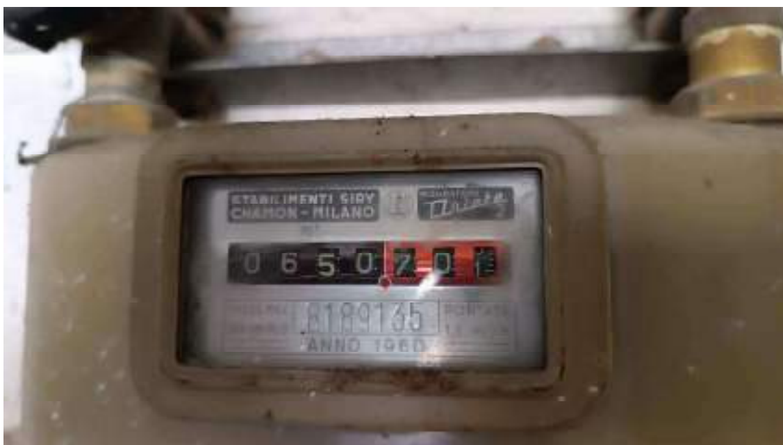
008 - PARTICOLARE CONTATORE GAS
